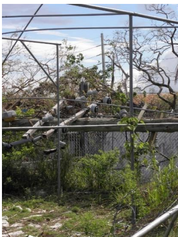
Le poteau électrique à haute tension
